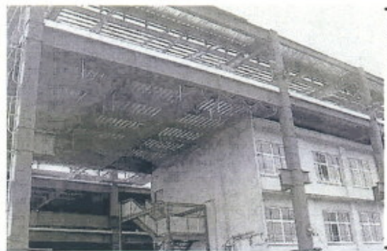
現校舎に新校舎の鉄骨をかぶせた三隈中の全面改築工事
